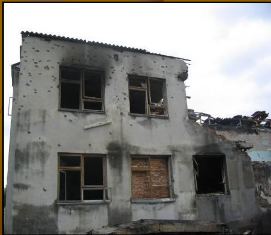
Школа, разрушенная в ходе теракта.
